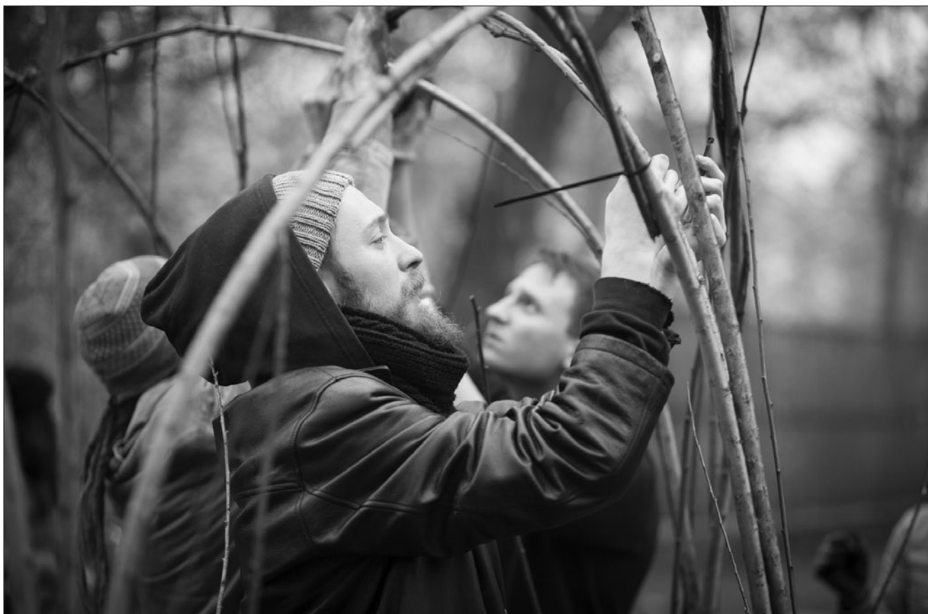
Fot. 3. Naturalny Ogród Zabaw. skwer u wylotu ul. Piekarskiej w Krakowie – powstaje wiklinowy szałas (fot. M. Wąsik)
